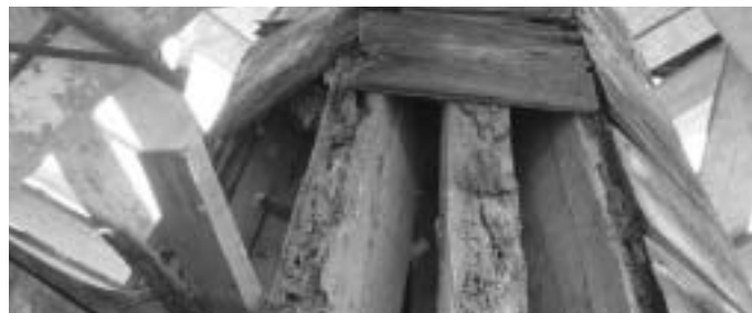
Die morschen Balken und Schalungsbretter erfordern eine neue Holzkonstruktion des Turmes.
