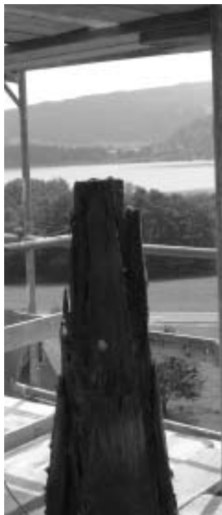
Der morsche Turm, 1872 errichtet, musste bis zu den Mauern abgetragen werden.
